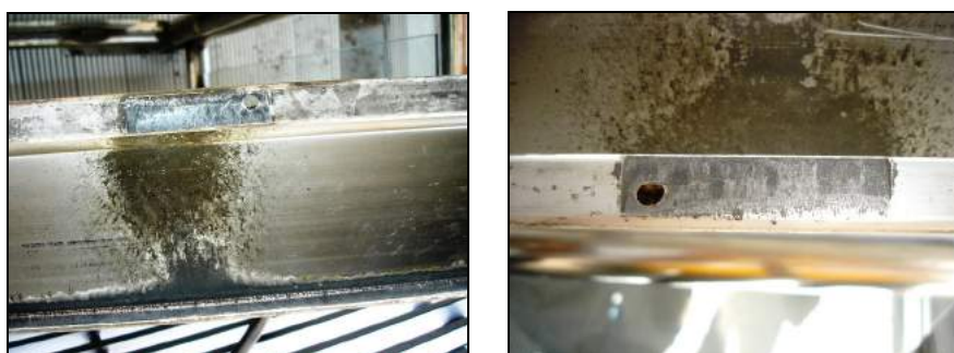
Figura 5-12 Daño en condición de apoyo.
