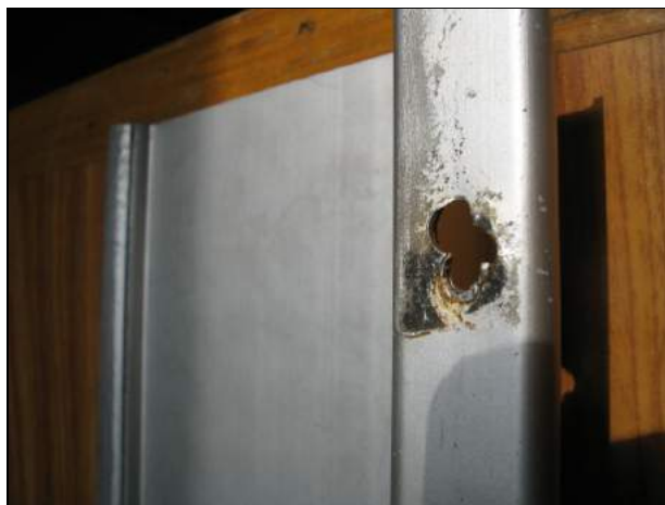
Figura 5-41 Perfil de aluminio 6261 T6. Vista de la aleta inferior de apoyo donde se observan varios orificios debido a posibles re-trabajos.
