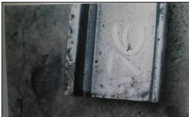
Figura 5-33 Desgaste en la parte inferior de un perfil
