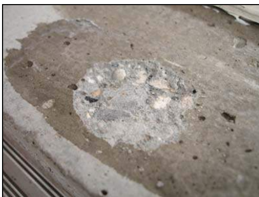
Figura 8.9-13 Ensayo de tensión de imprimante en concreto pretensado, se observa la falla del sustrato
