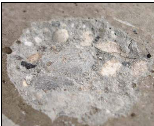
Figura 8.9-2 Desprendimiento del concreto (ensayo de tensión en sustrato concreto pretensado)
