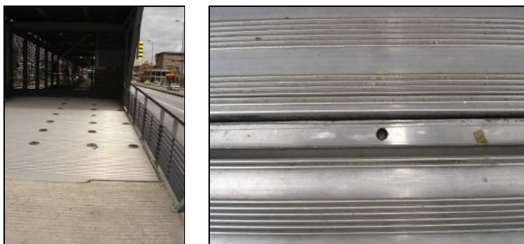
Figura 5-14 Pérdida de láminas
