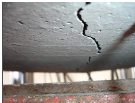
Figura 8.3-12 Mecanismo de falla del material fallado a flexión
