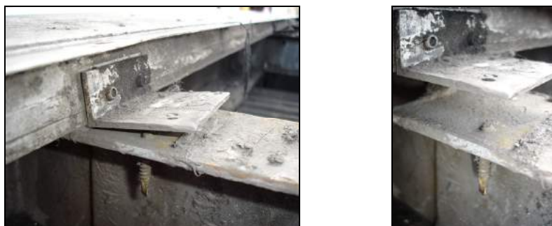
Figura 5-8 Generación de ruido por desajuste en apoyos.
