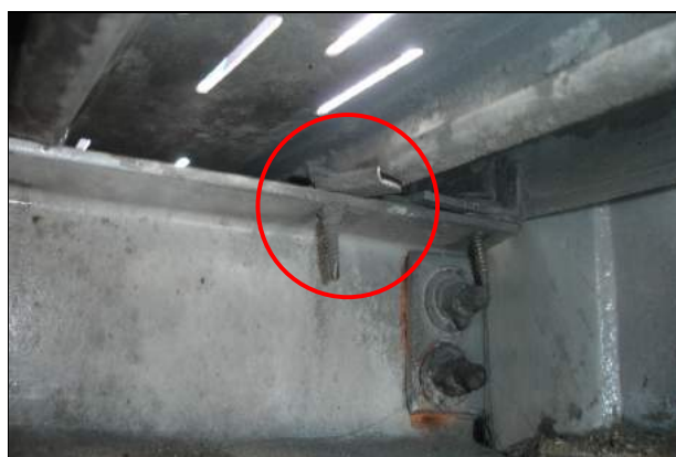
Figura 5-36 Fractura total de la aleta del perfil de aluminio donde está sujetado
