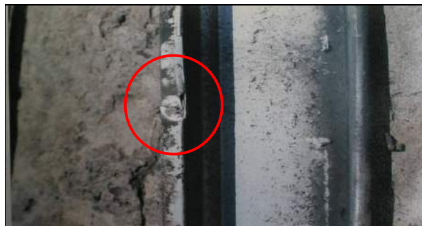
Figura 5-35 Detalle de un punto de sujeción fallado
