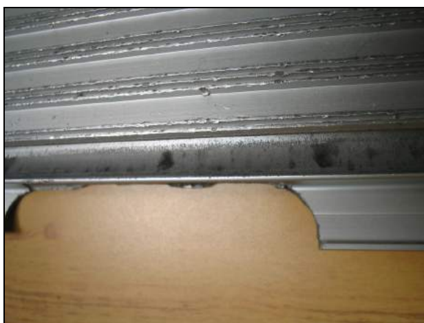
Figura 5-43 Detalle de fractura generada por abrasión en el interior de la canal localizada sobre el punto de sujeción que falló.
