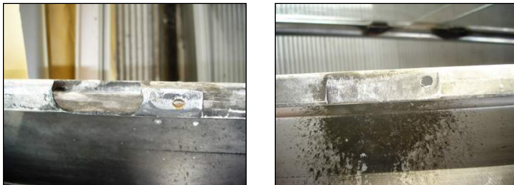
Figura 5-13 Daño en condición de apoyo
