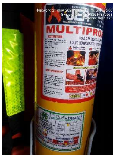
Foto 4: Extintor de 10 lb, con vencimiento hasta abril de 2022.
