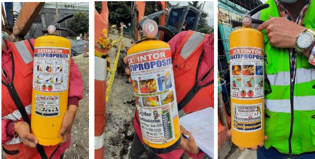
Foto 11, 12 y 13: Revisión de vigencia de equipo de emergencias y extintor de la maquinaria de los móviles 006 y 008.
