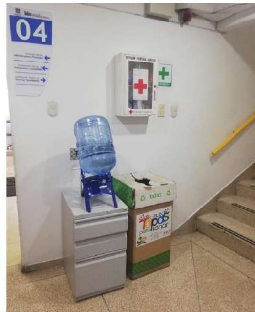
Al costado, en el mismo piso, la ruta de evacuación y el botiquín, se encuentran obstaculizados por un cajón archivador, un botellón de agua y una caja para recolección de tapas.
