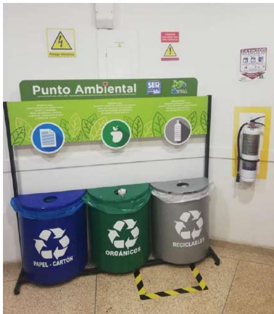
En el piso 4 de la Calle 22, se observó una señal que indica "Mantener el área despejada"; sin embargo, se encuentra obstaculizada por un punto ambiental
