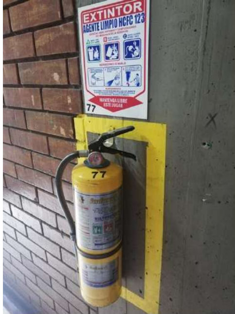
En el piso 4 de la Calle 20, se observó extintor multipropósito identificado de manera errada como "extintor agente limpio HCFC 123"
