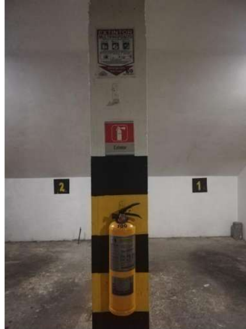
Mientras que en el sótano de la misma sede, se observó extintor multipropósito identificado de manera adecuada como "extintor multipropósito"
