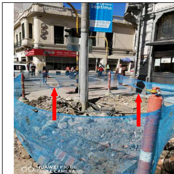
Foto No. 5 Cerramiento desgastado.
