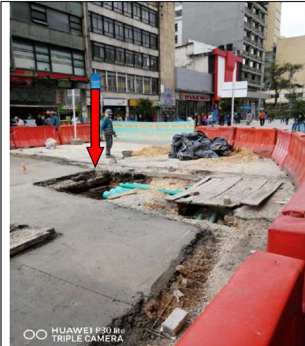
Foto No. 12 Frente de obra sin señalización de excavaciones profundas.
