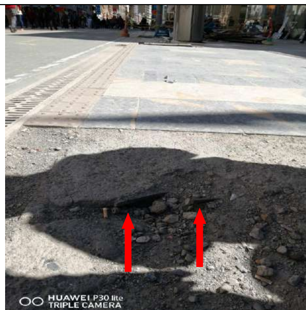
Foto No. 6 Varillas expuestas.
