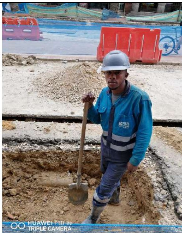
Foto No. 10 Trabajador sin elementos EPP.
