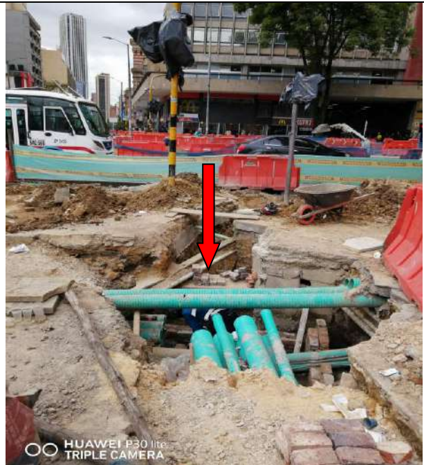
Foto No. 13 Frente de obra sin señalización de excavaciones profundas.
