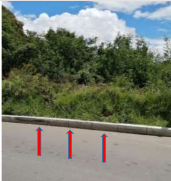
Foto N.º 20. Elementos desportillados.
