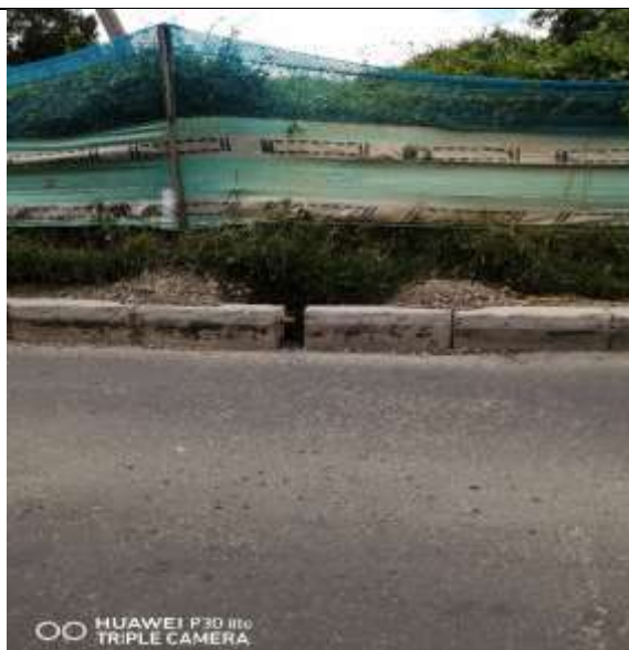
Foto N.º 21. Elementos sin confinamiento.
