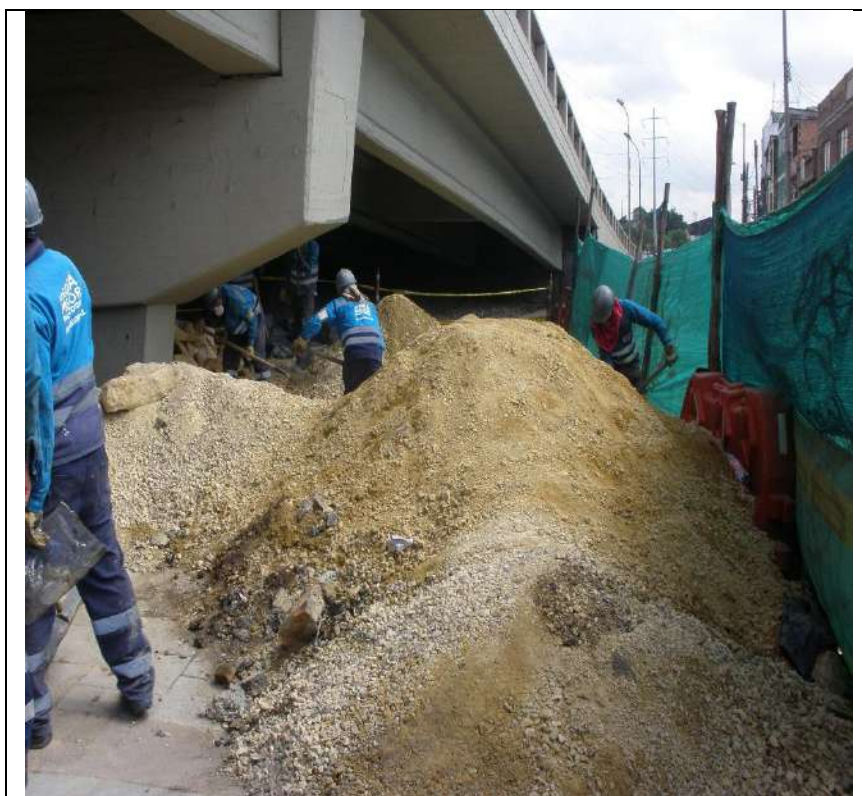
Foto No. 1. Acopio de material de construcción, sin señalización.
