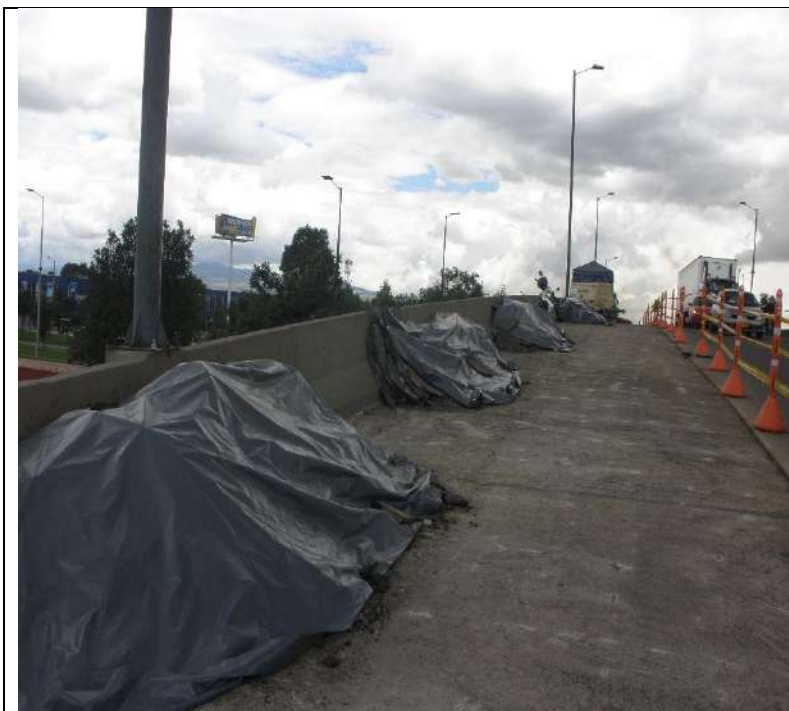
Foto No. 2. Acopio de material de construcción, sin manejo de acopio y señalización.
