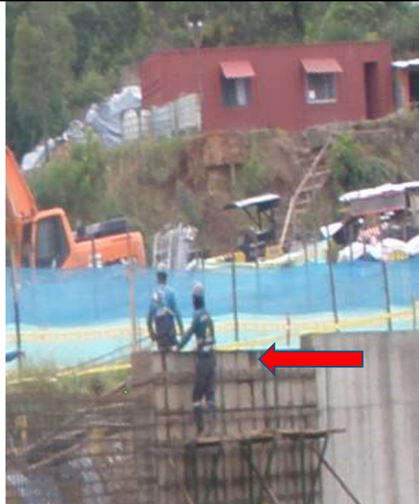
Foto No. 5. Trabajo en altura con arnés sin asegurar.
