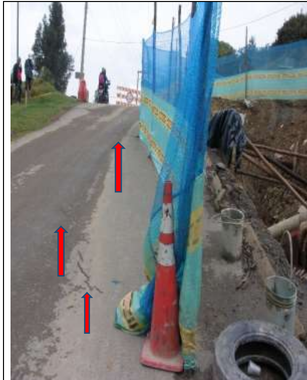
Foto No. 9. Fisuramiento longitudinal.
