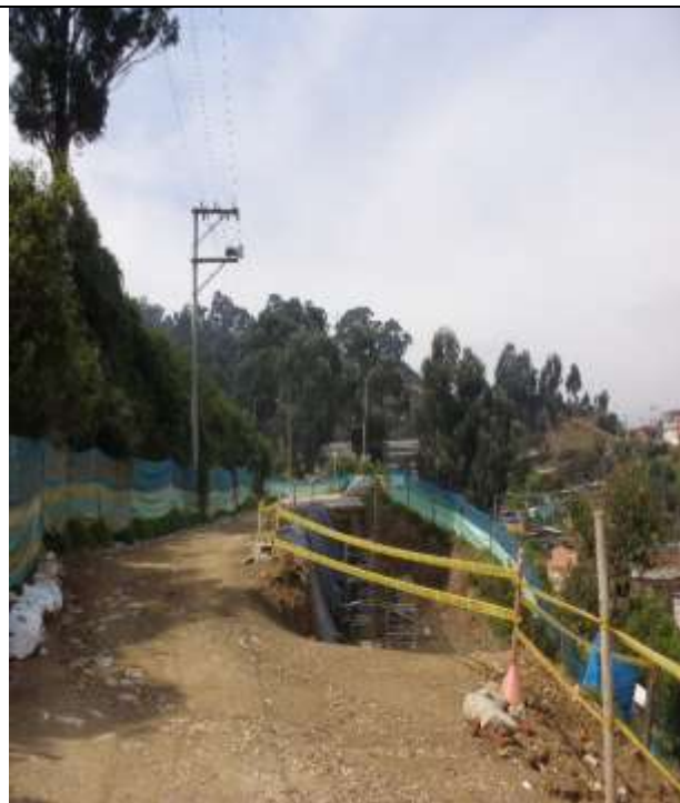
Foto No. 7. No se observa aviso de excavación profunda.
