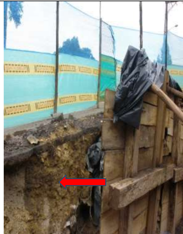
Foto No. 10. Socavación mínima.
