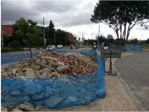
El manejo de los escombros es inadecuado.
