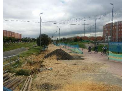
Los materiales de obra se encuentran desprotegidos y a la intemperie.
