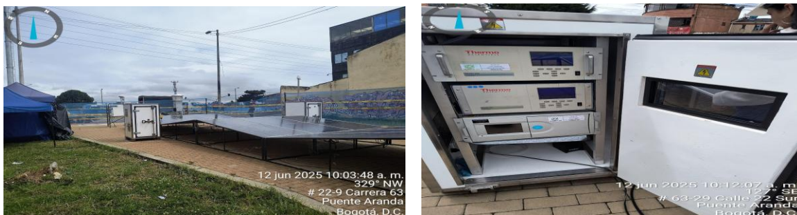
Imagen 24. Paneles solares para alimentación eléctrica sistema de monitoreo Grupo 1 Av. Carrera 68
