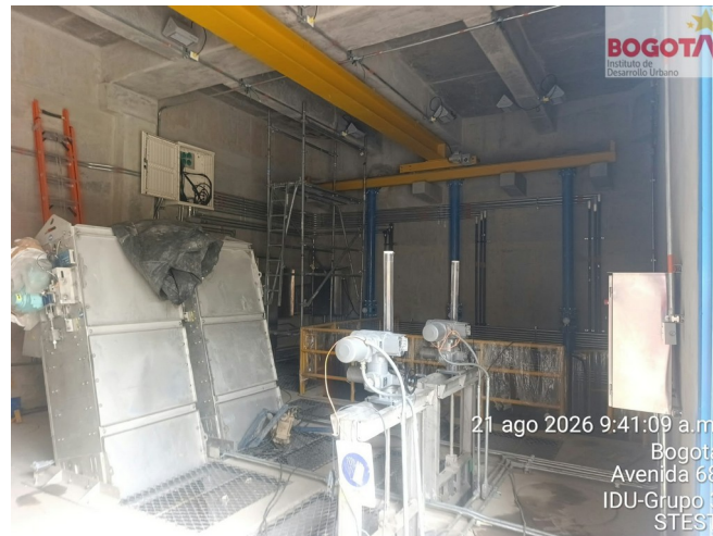
Estación de bombeo - deprimido
