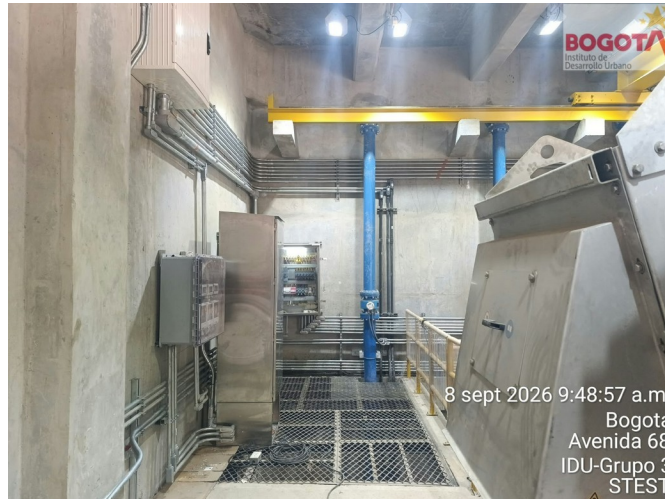
Estación de bombeo - deprimido
