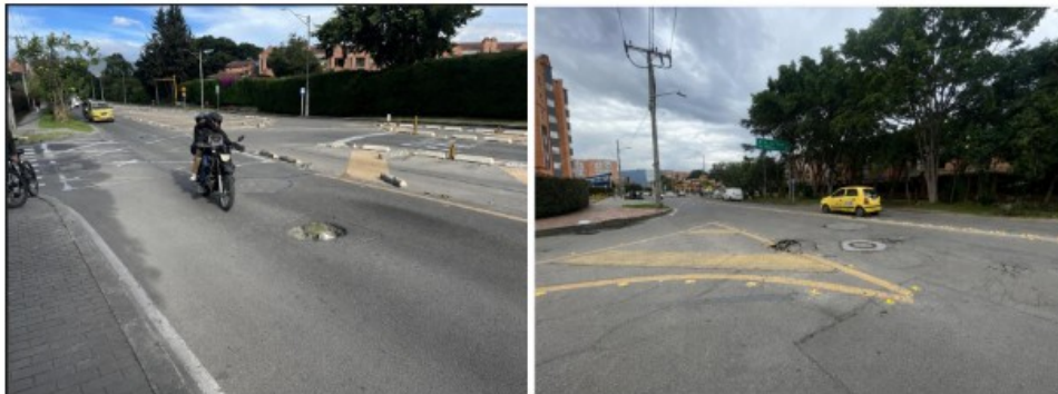
Ilustración 1. Estado actual de los segmentos PK 516233 -CIV 11007120, PK 516239- CIV 11007333 Avenida Camio del Prado - Calle 138 con Carrera 73.
