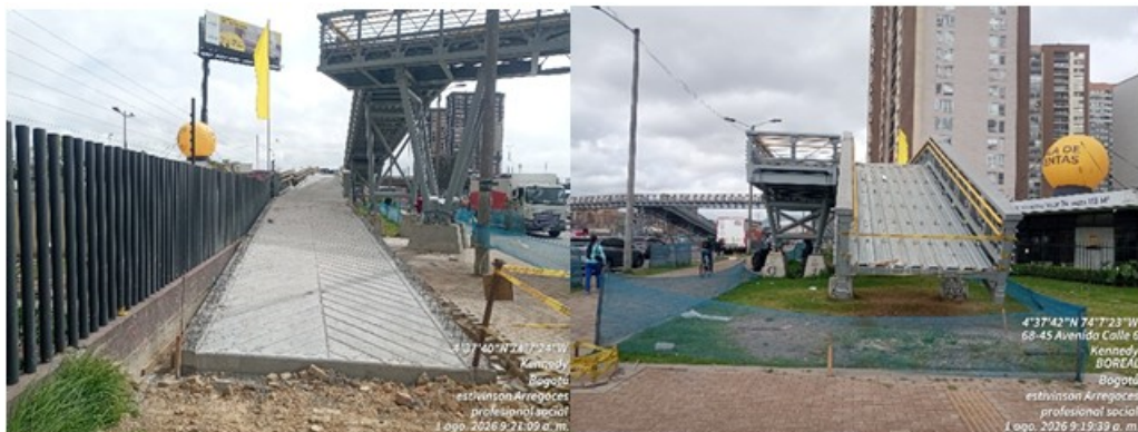
Fotografías 1 y 2. Obras pendientes por terminar en el puente peatonal 4. Fuente: Elaboración propia
