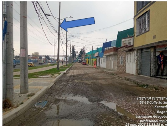
Interferencias que impidieron la terminación de obras en tiempo programado. Fuente: Elaboración propia
