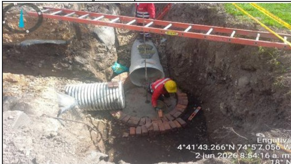
Fotografía N°2: Red pluvial del costado oriental.
