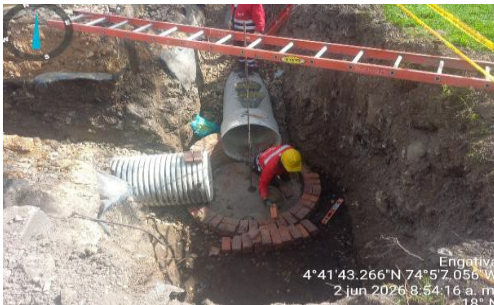
Fotografía N°2: red pluvial del costado oriental.
