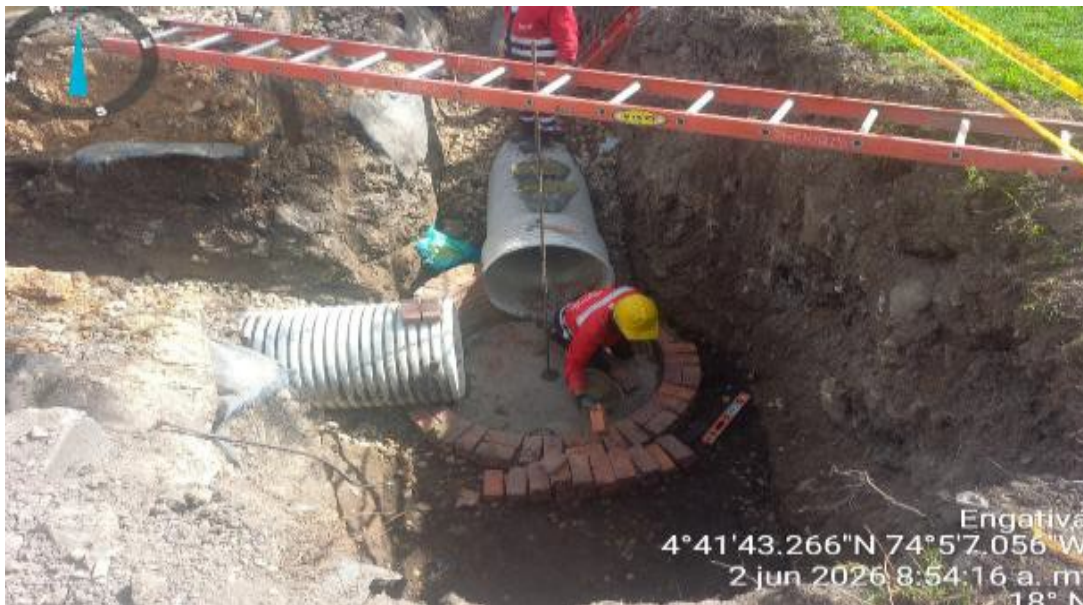
Fotografía N°2: red pluvial del costado oriental.
