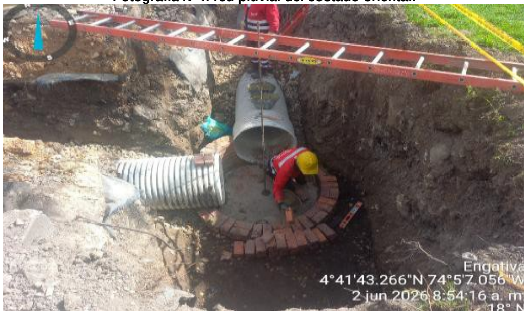
Fotografía N°4: red pluvial del costado oriental.
