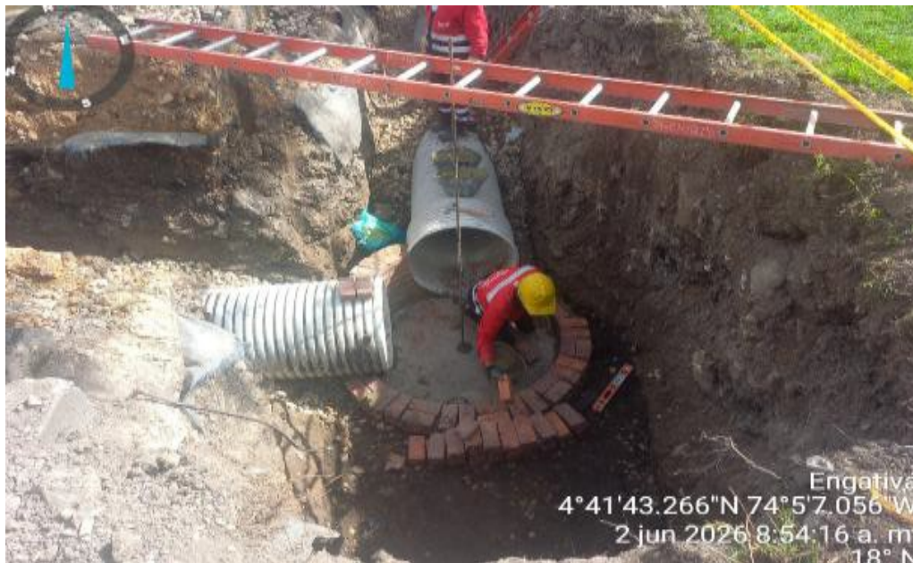
Fotografía N°2: red pluvial del costado oriental.
