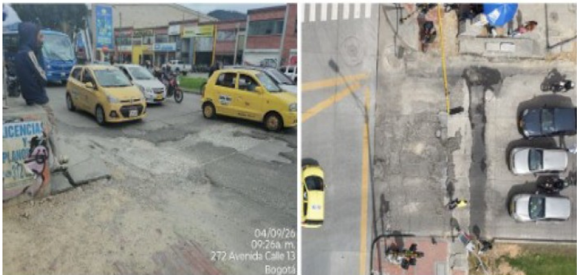
Imagen 2: Identificación de afectaciones en la visita de Contratista IDU-1510-2025 e interventoría
