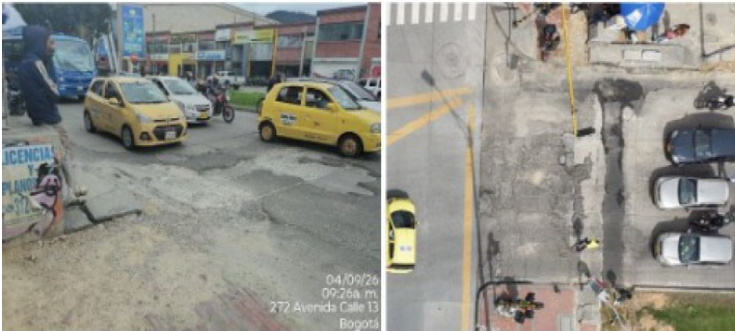
Imagen 2: Identificación de afectaciones en la visita de Contratista IDU-1510-2025 e interventoría
