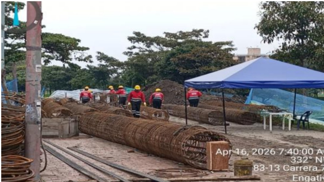
Fotografía N°3: Amarre y figurado de acero para canastilas de pilotes del costado occidental.
