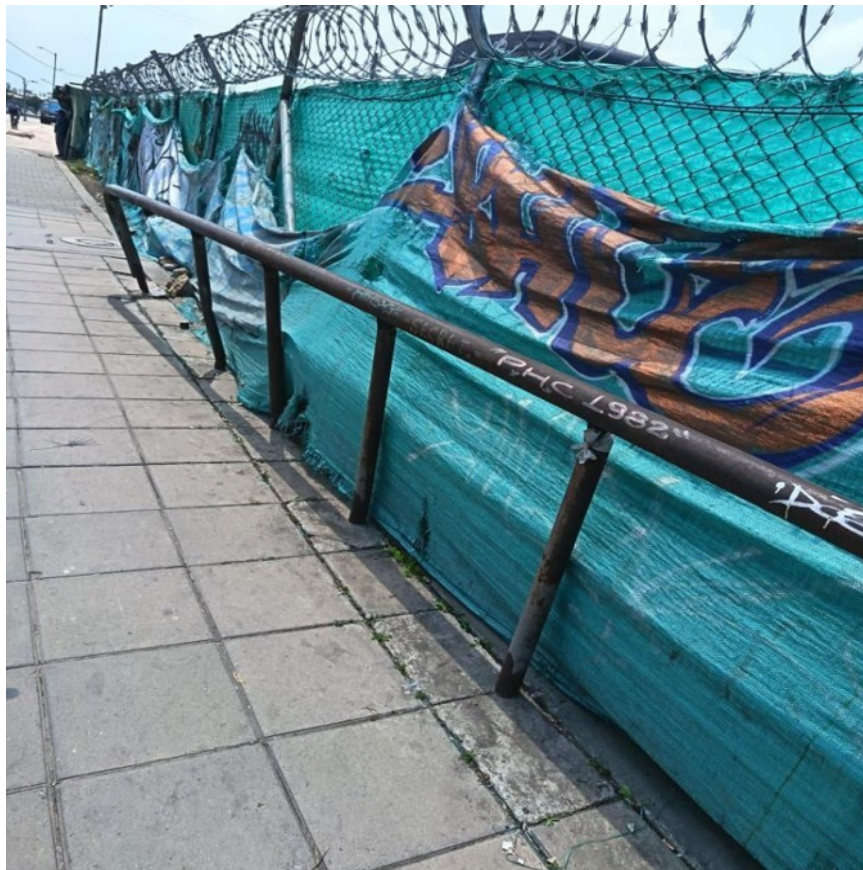
Imagen 1- PKID- 92084018 – Cerramiento provisional contra la baranda objeto de solicitud
