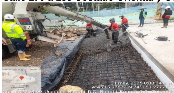
Fundida placa de aproximación canal El redil
