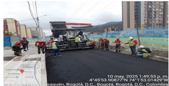
Instalación MD-20, MS-12 y MD-12 entre calle 188 - 189
