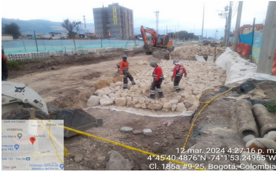
Instalación Rajón para vía.
