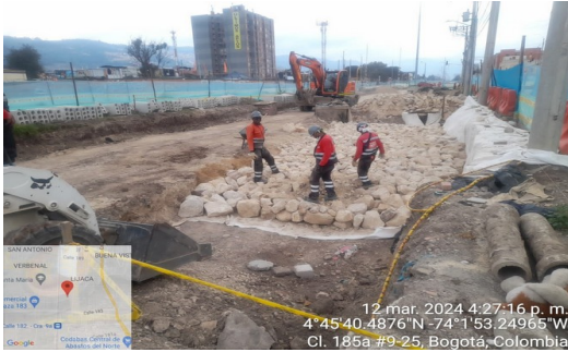
Instalación Rajón para vía.
