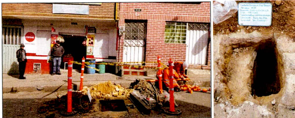
Imagen 2. Apiques y medición de espesores CIV 4001432.
