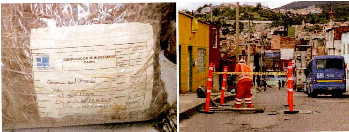
Imagen 3. Apiques y medición de espesores CIV 4001432.
