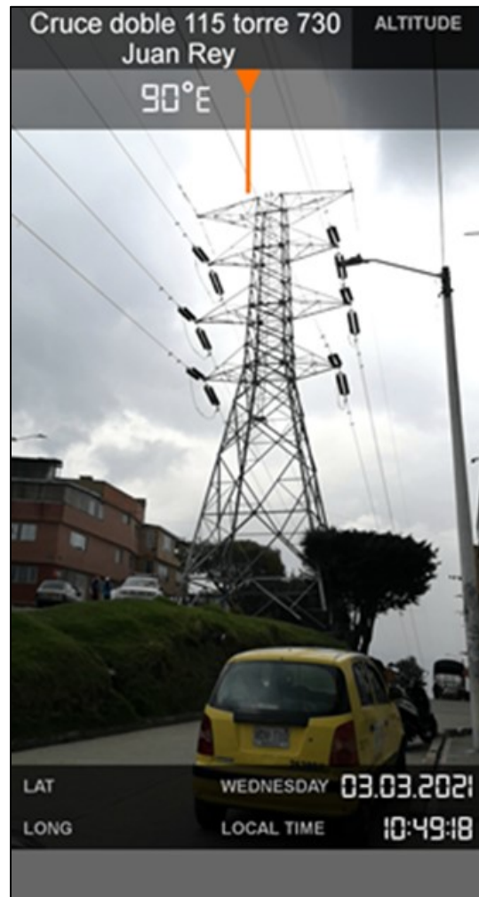
Figura 65 - Apoyo No.730 Red doble circuito 115kV Usme-Circo y la Victoria-Circo Fuente: Elaboración propia equipo redes secas contrato de Consultoría 1630 de 2020
