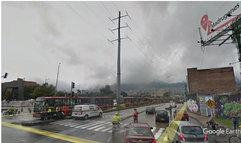
Figura 81 - Imagen de referencia - Poste con redes AT doble circuito 115kV-57,5kV Ubicación: Calle 6 Carrera 14 Bogotá Fuente: Imagen tomada de Google Earth (4 de abril de 2021)
