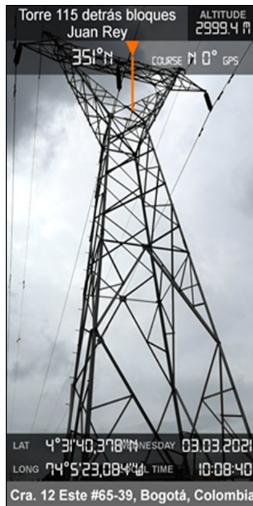
Figura 63 – Apoyo No. 55 línea 115kV circuito La Victoria-Cáqueza Fuente: Elaboración propia equipo redes secas contrato de Consultoría 1630 de 2020
