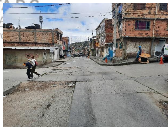
Carrera 3A Este con Calle 40 Sur: Baches, losas escalonadas, losas subdivididas que acogen pozos de inspección, grietas de esquina.
