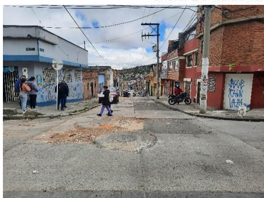
Calle 40A Sur por Carrera 3CEste: Baches, losas subdivididas, parcheos en concreto asfáltico, juntas muy abiertas. Deños en bordillos y losas de andenes.
