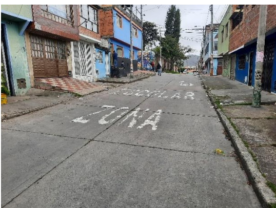
Carrera 3A Este por Calle 41Sur: Juntas abiertas, por lo demás, las losas ofertan buen estado, pero no los andenes.
