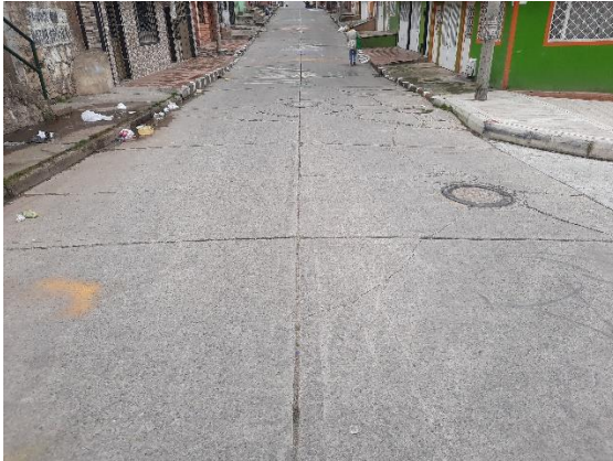
Intersección Calle 43Sur con Carrera 12B Este: Losas atípicas fracturadas, que albergan pozos de inspección, grietas de esquina y juntas muy abiertas y sello escaso. Andenes con buen acabado como otros en regular estado.
