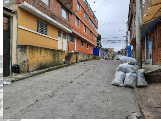
Carrera 12A Este entre Calles 43Sur y 43A Sur: Losas ofertan buen aspecto pero las juntas están desproistas de material de sello. Escalonamiento acentuado en los andenes, tanto longitudinal como transversalmente, prima el regular estado de las superficies de los pavimentos de andenes.
