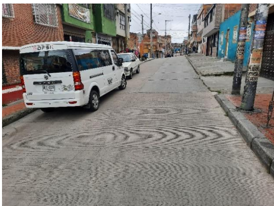
Carrera 3C Este por Calle 41Sur: Se aprecian losas en buen estado aunque con escalonamientos leves.
