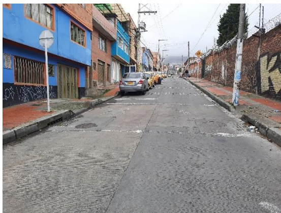
Calles 41Sur entre carreras 3A Este y 3C Este: andenes en pavimento articulado en buen estado. Losas ofertan buen comportamiento pese a que sus juntas están muy abiertas, sin sello.
