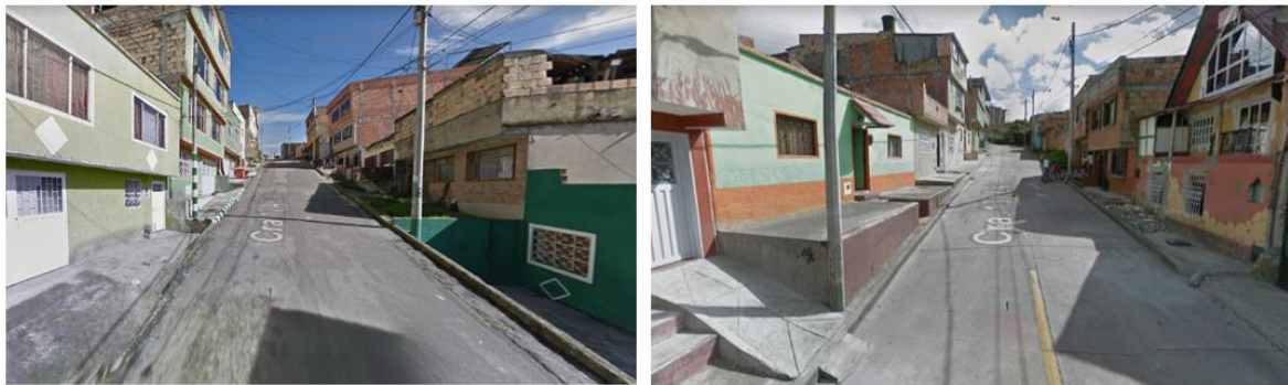
Fotografía 10. Discontinuidades en andenes sector Altamira
