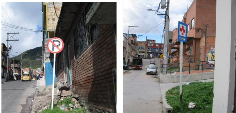
Fotografía 9. Estado de la infraestructura peatonal centro de Atención prioritaria Altamira
