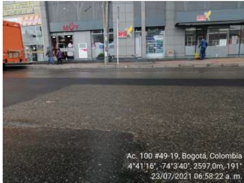
Registro fotográfico: Estado actual del pavimento vial
