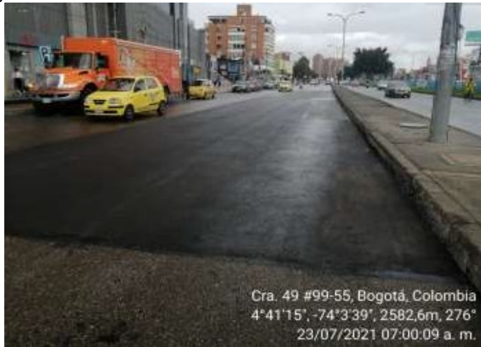
Registro fotográfico: Estado actual del pavimento vial
