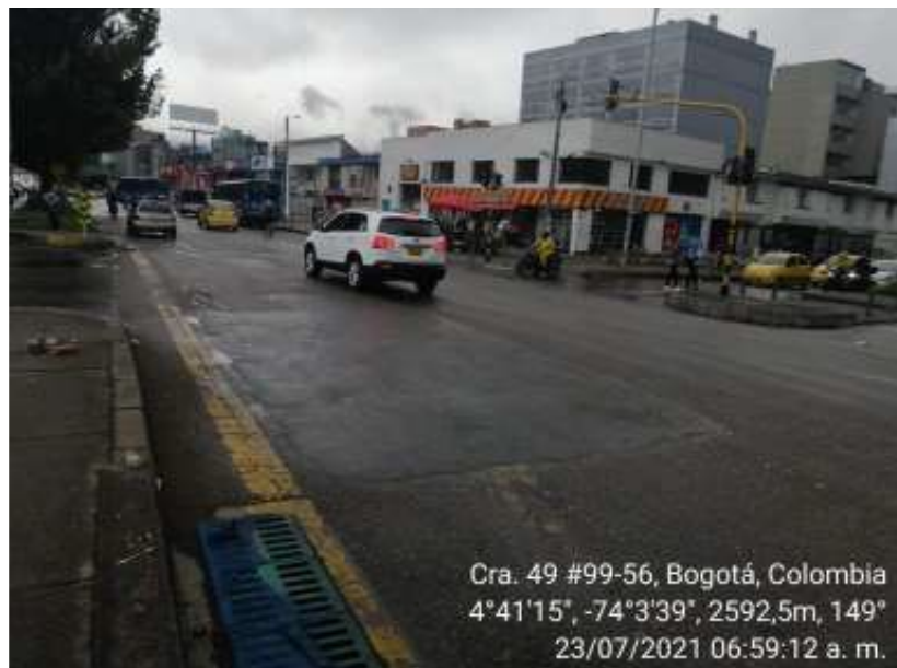
Registro fotográfico: Estado actual del pavimento vial
