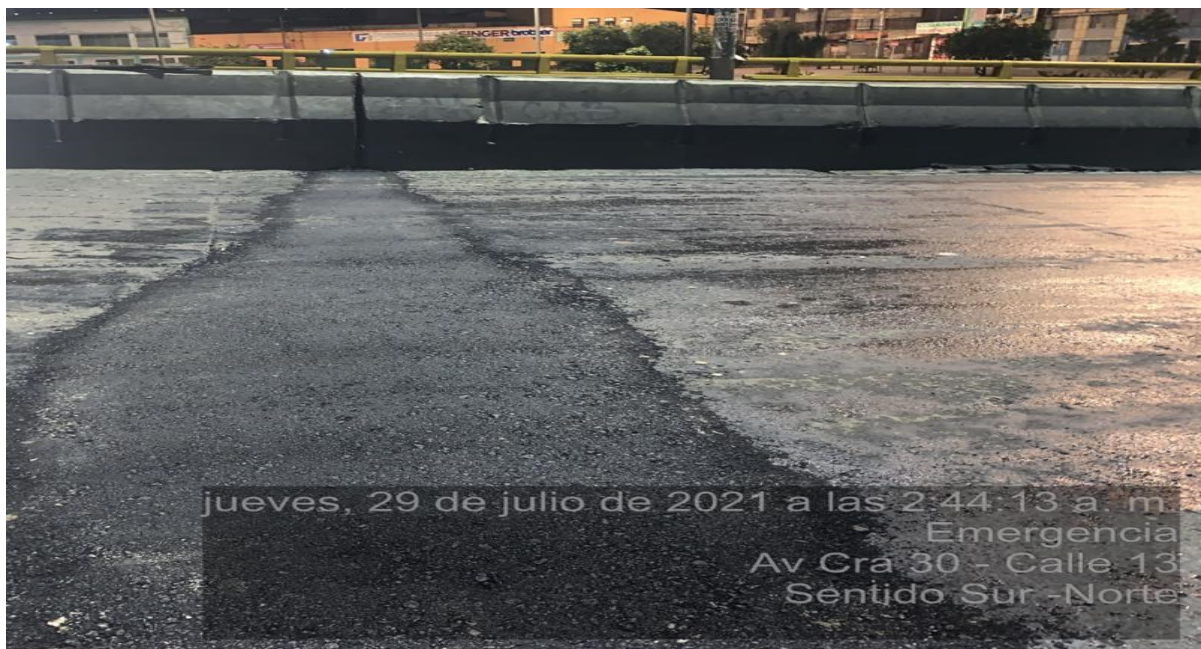
Foto 1: Estado actual tablero puente Avenida Ciudad de Quito por Avenida Centenario
