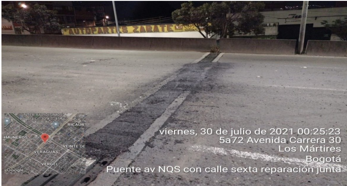
Foto 2: Estado actual tablero puente Avenida Ciudad de Quito por Avenida de los Comuneros
