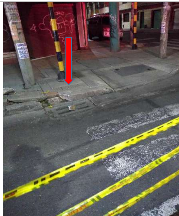
Foto No. 5 Sumideros sin protección.
