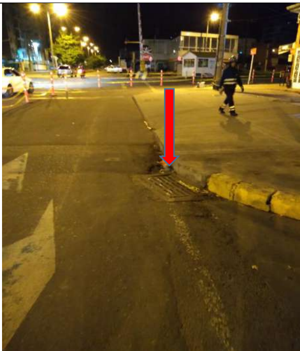
Foto No. 4 Sumideros sin protección.
